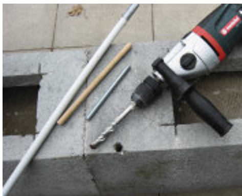
Kontrolle leicht gemacht: Hier wurde ein Loch für den hölzernen Signalstab gebohrt.
